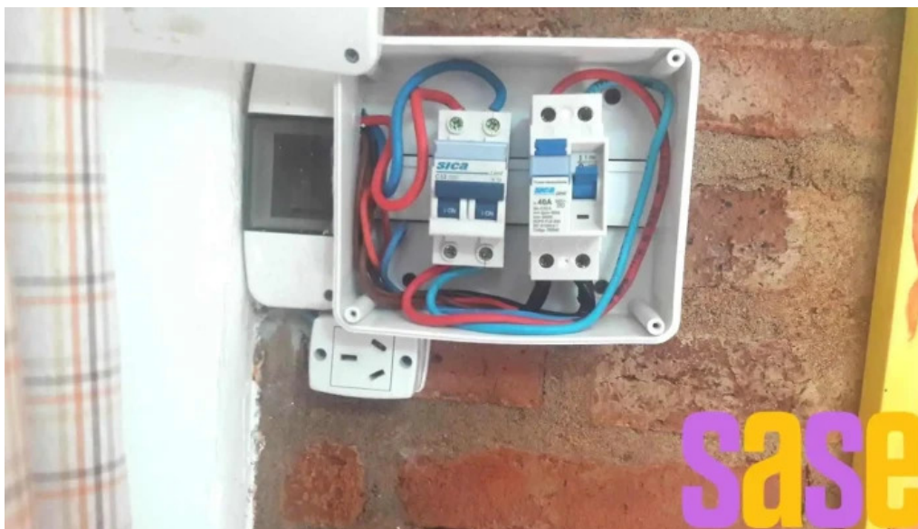
Electron instalaciones electricas y sistemas de seguridad obra
