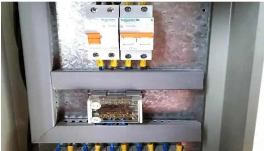
Induelectric proyectos y soluciones electricas del propietario
