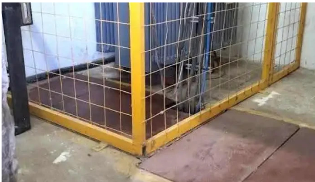
Velasco transformadores la leonesa
