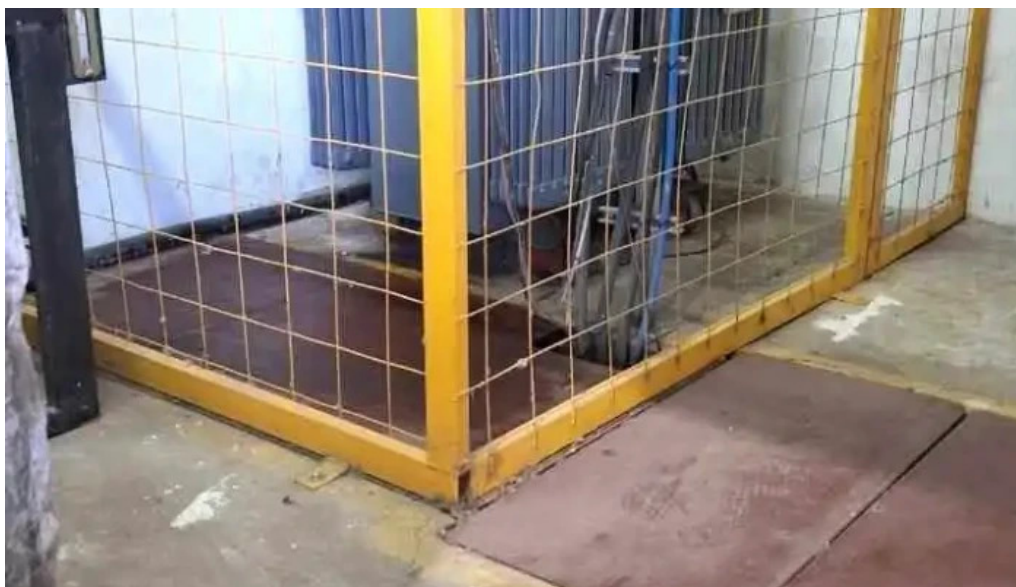
Velasco transformadores zona
