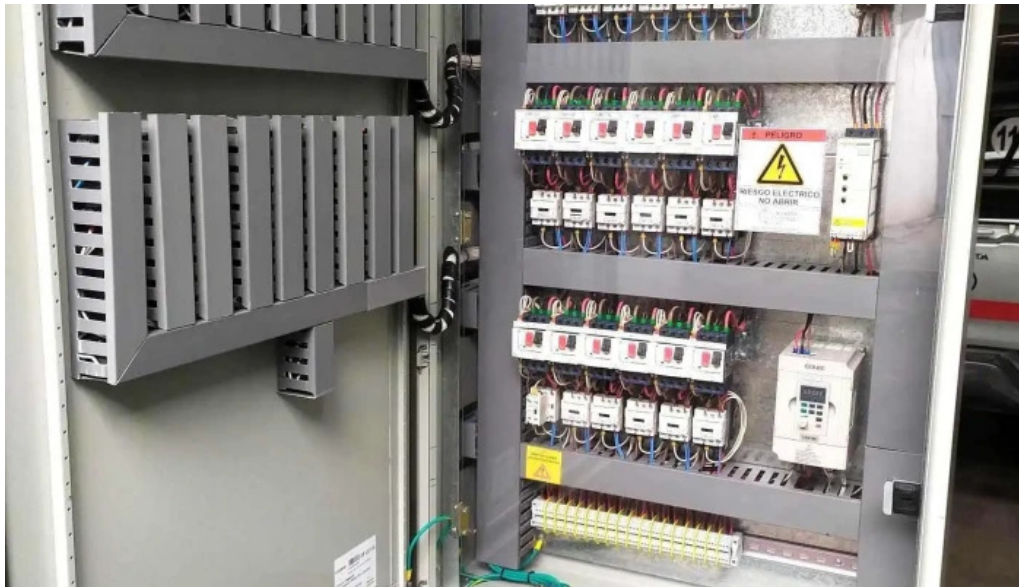
Ingenieria electrica salta fotos
