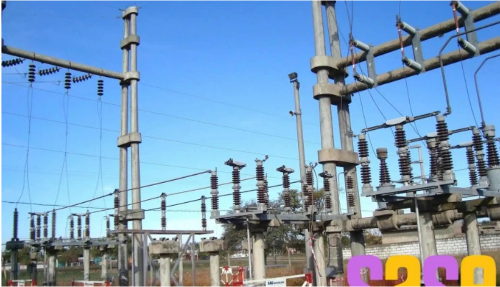
Sag electricidad srl del propietario
