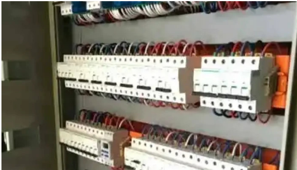
Electricista artal electricidad del propietario
