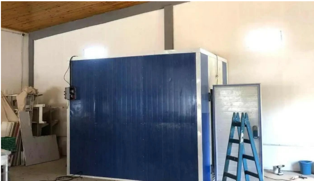
Mauricio ceroleni camaras de frio servicios electricos interior
