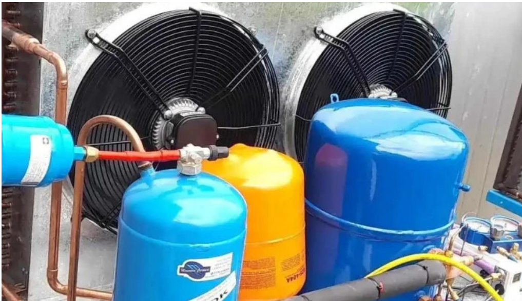
Mauricio ceroleni camaras de frio servicios electricos mocoreta
