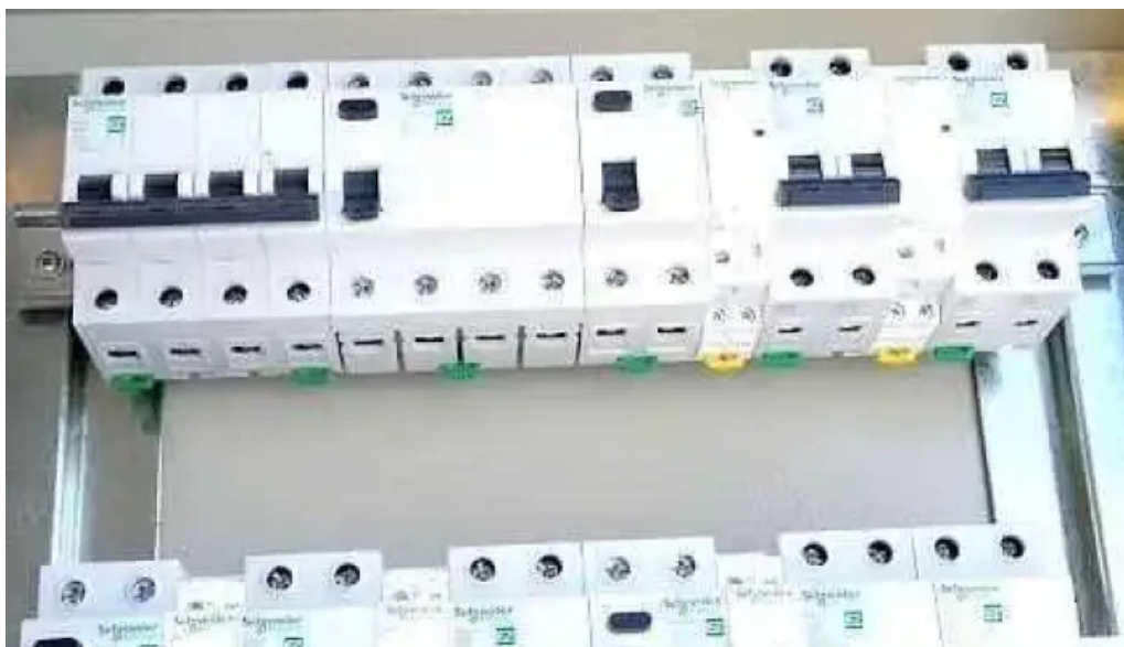
E y e instalaciones machagai
