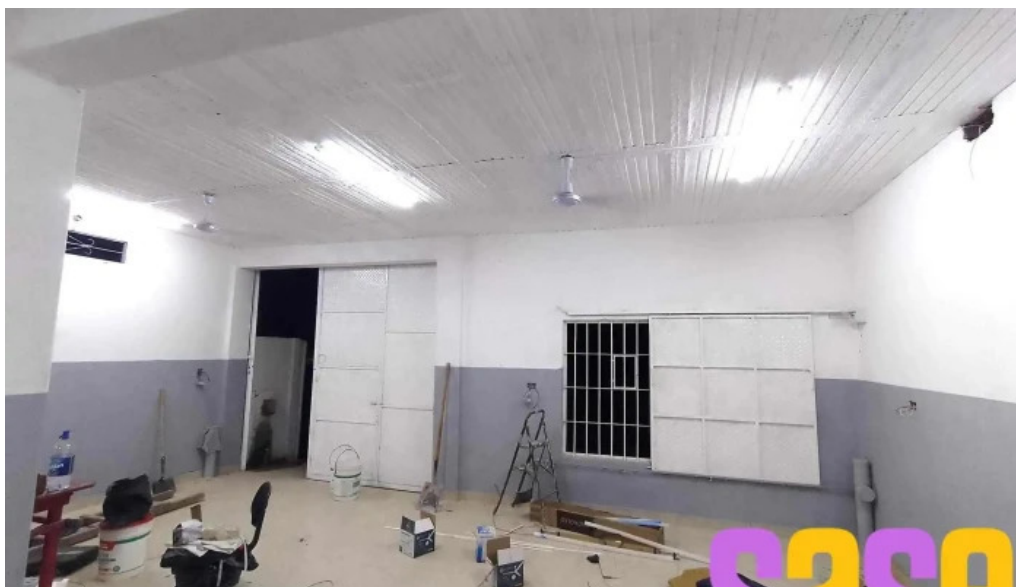
Cmf electricidad refrigeracion interior
