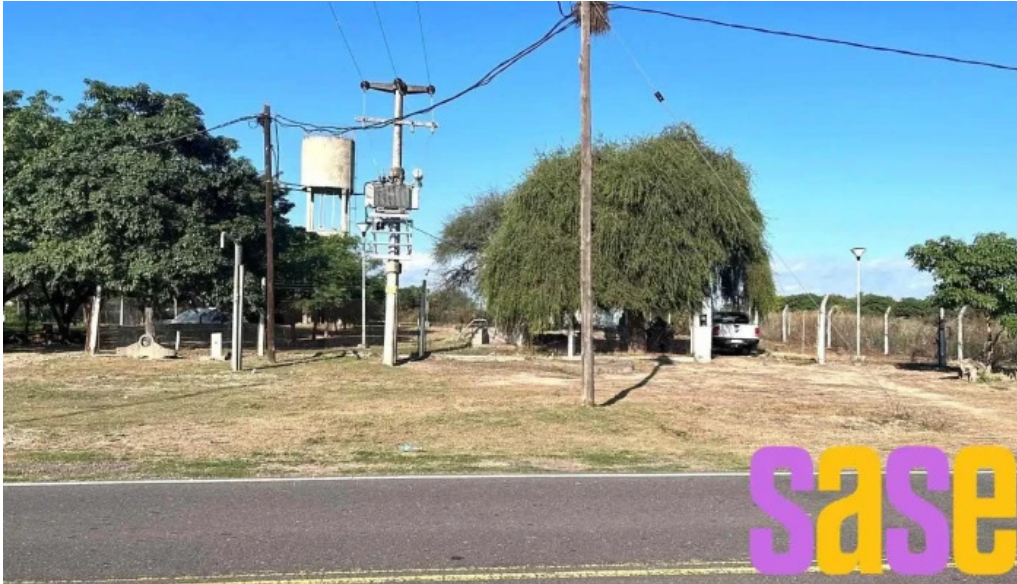
Estacion de bombeo diosse instagram
