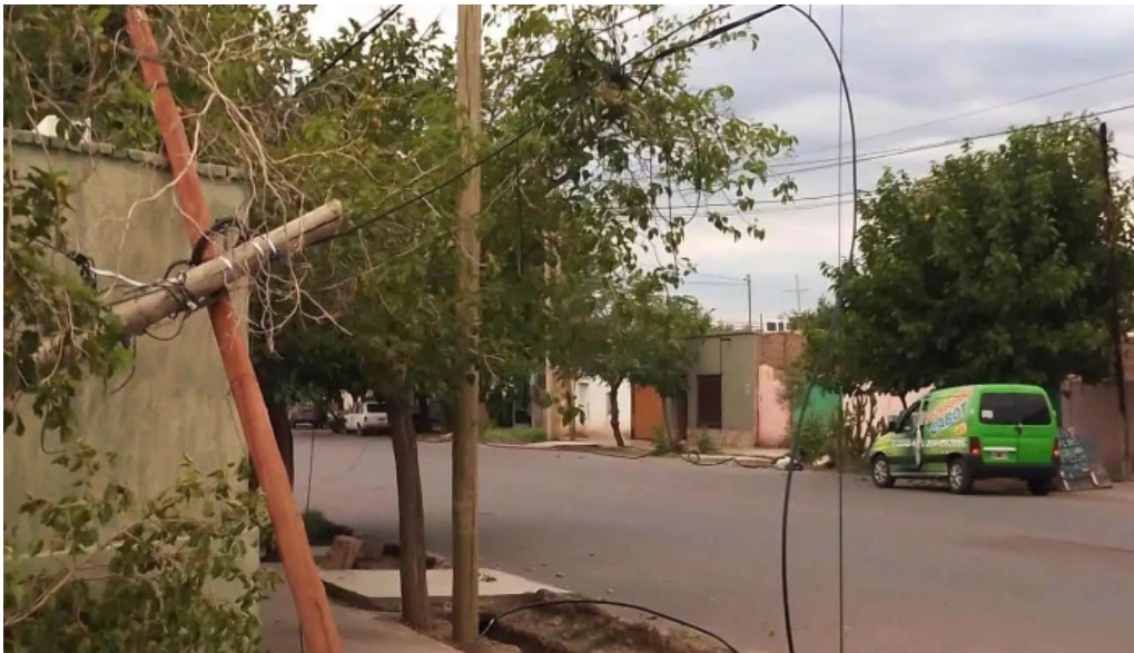
Energia san juan sa sitio web
